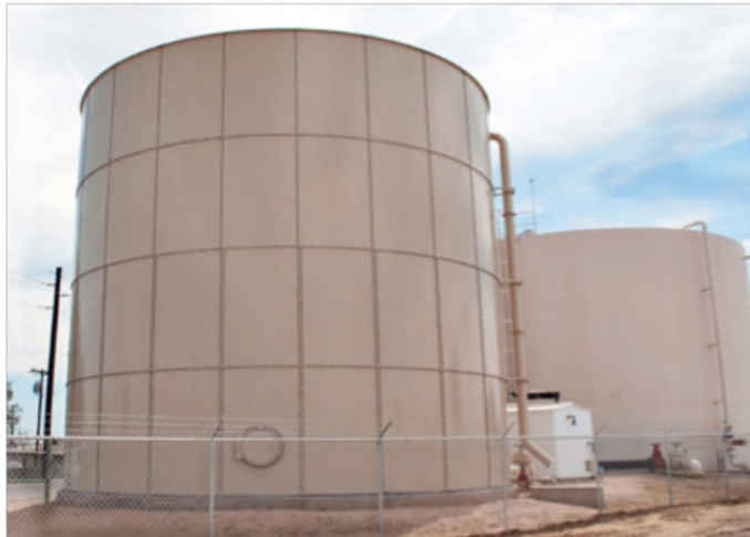
1 TANQUE DE ALMACENAMIENTO Y DISTRIBUCIÓN
